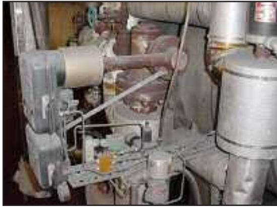
A modernização dos controles de nível dos aquecedores AA permite aos operadores uma melhor administração de perdas controláveis, e ao mesmo tempo uma redução significativa nos custos de manutenção. Deslocadores de tubo de torção (acima) são comuns no setor, e estão entre os métodos mais fáceis de reabilitação.
